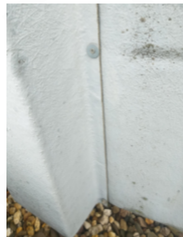
Afbeelding 5 - Hier is te zien dat er al een poging is gedaan de schroeven van de kap te verwijderen. Dit was alleen te herstellen met nieuwe schroeven.
