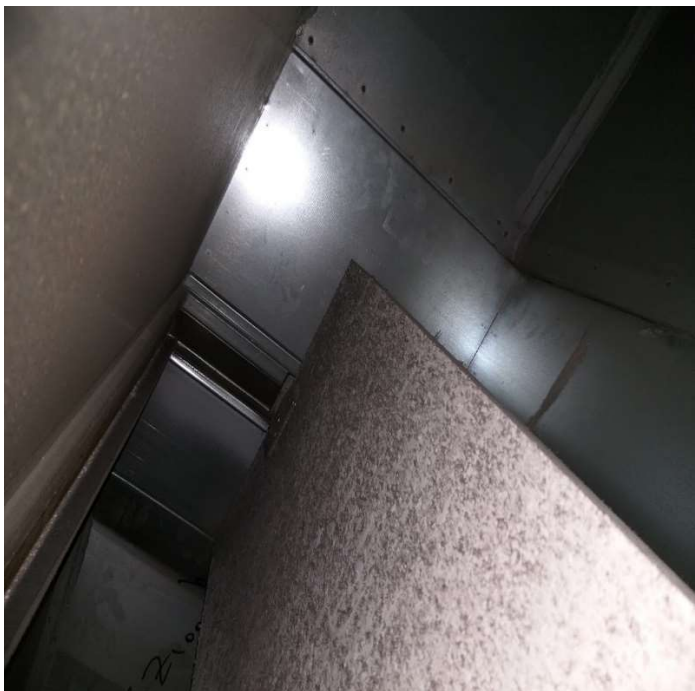
Licht vervuilde brandklep
