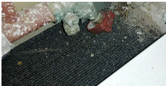
Afsluiter Aanvoer A handwiel vast
