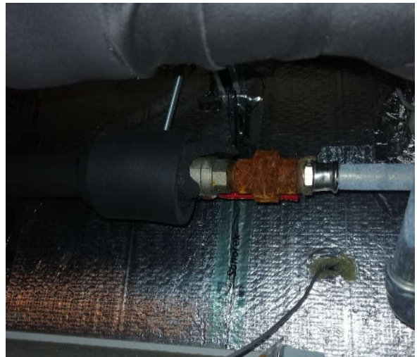
Koppelingen aangetast en niet geïsoleerd
