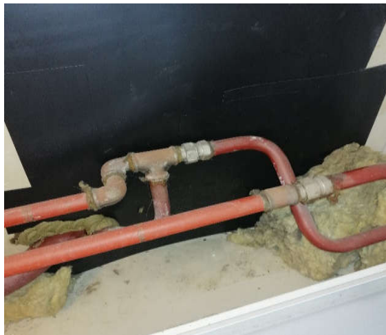
Inregelafsluiter aanvoer weggewerkt !
