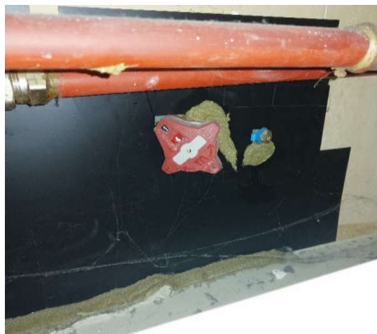
Inregelafsluiter aanvoer A ingebouwd in wand
