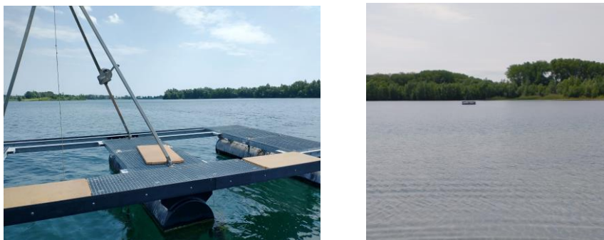
Figuur 4.8 | Inlaatpunt midden op het water bevestigd aan een drijvend ponton.
