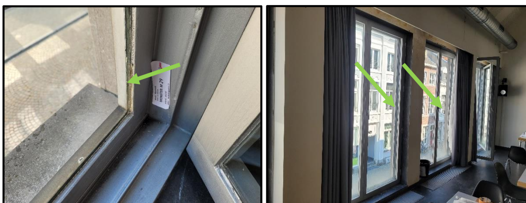
M24 – dit monster bleek na analyse niet asbesthoudend
