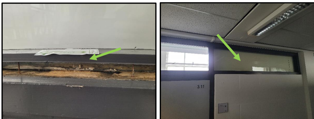
M64 – dit monster bleek na analyse niet asbesthoudend
