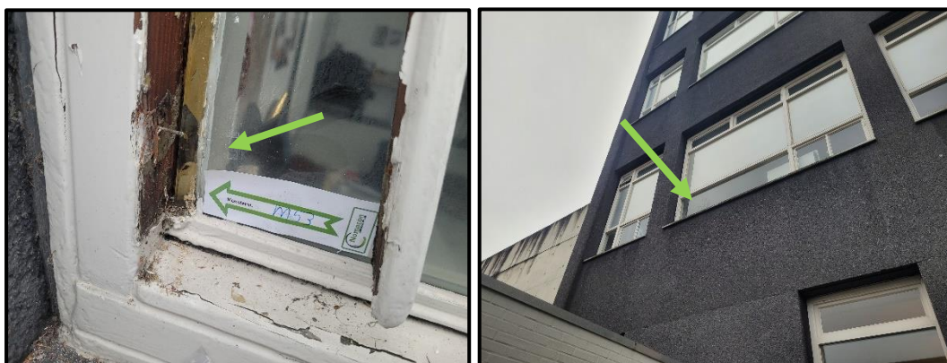
M53 – dit monster bleek na analyse niet asbesthoudend
