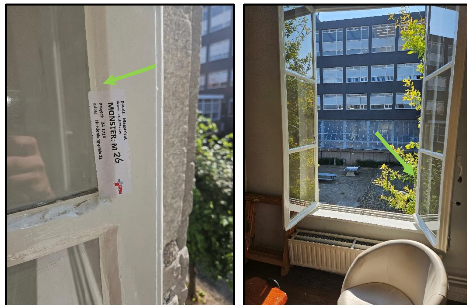
M26 – dit monster bleek na analyse niet asbesthoudend
