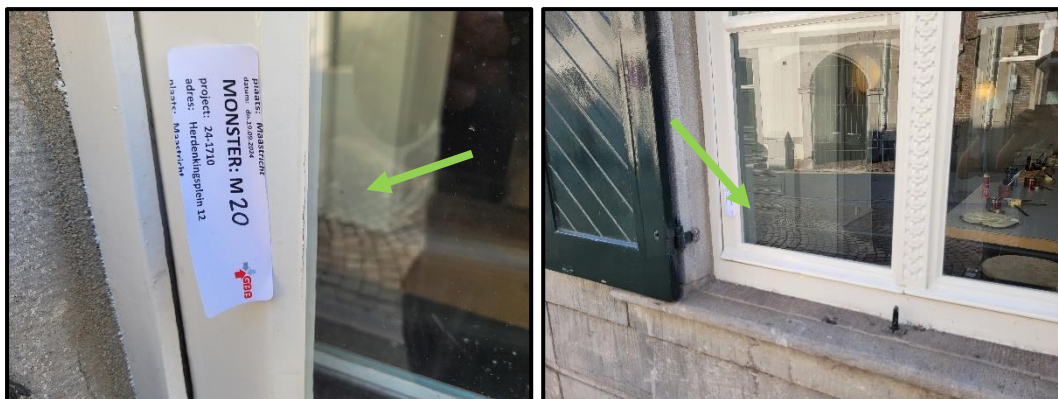
M20 – dit monster bleek na analyse niet asbesthoudend
