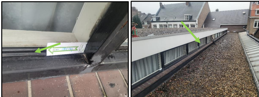
M47 – dit monster bleek na analyse niet asbesthoudend
