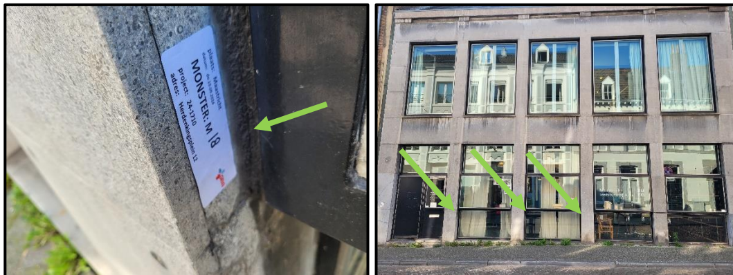
M18 – dit monster bleek na analyse niet asbesthoudend
