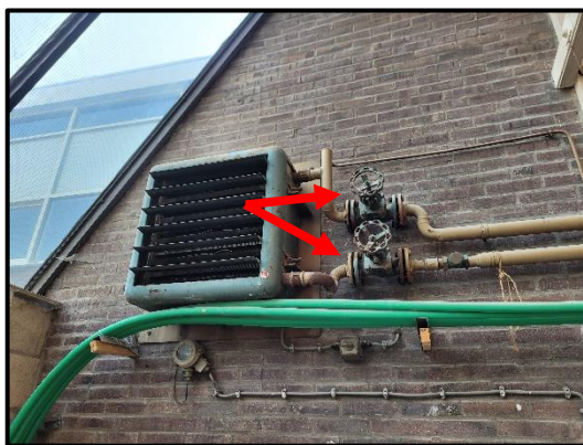
Bron 3: asbesthoudende pakkingen tussen flenzen afsluiters luchtverwarmer.
