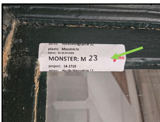
M23 – dit monster bleek na analyse niet asbesthoudend
