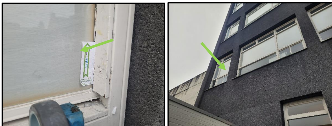
M52 – dit monster bleek na analyse niet asbesthoudend
