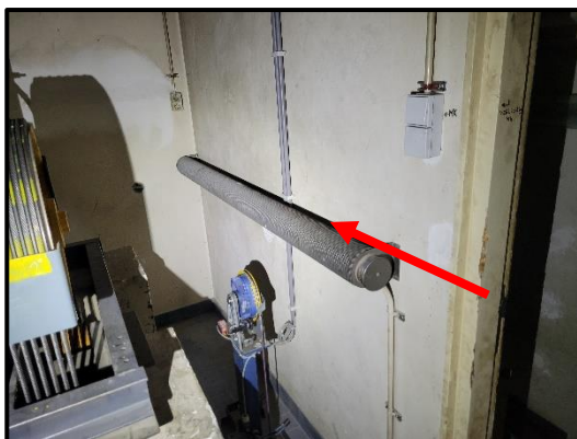
T4: spiraalkachel is asbestverdacht.
