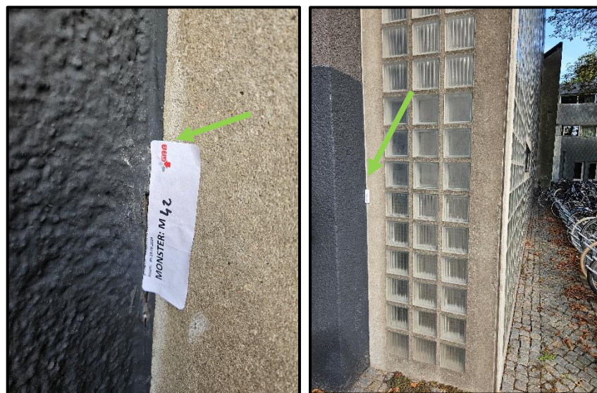
M42 – dit monster bleek na analyse niet asbesthoudend
