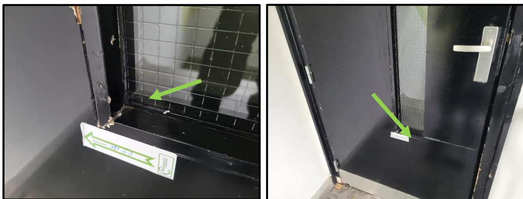
M63 – dit monster bleek na analyse niet asbesthoudend
