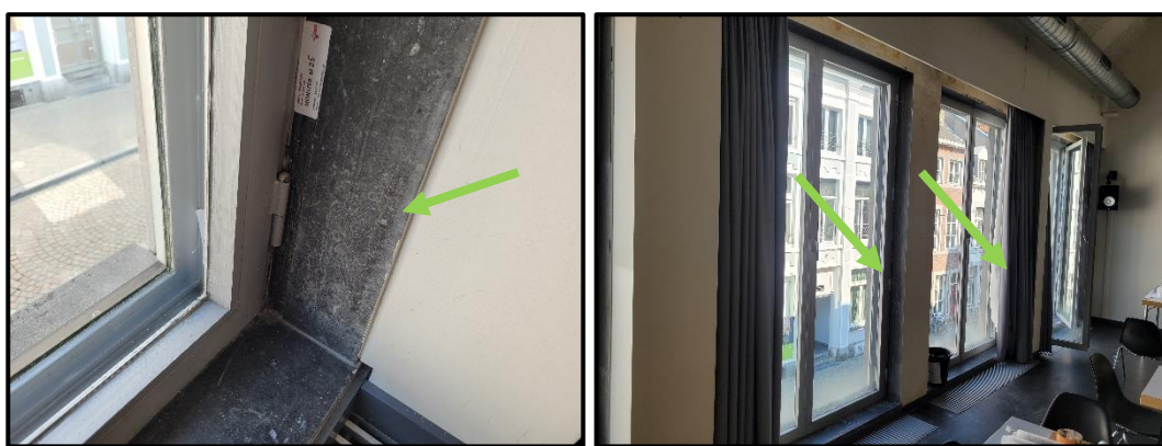
M25 – dit monster bleek na analyse niet asbesthoudend
