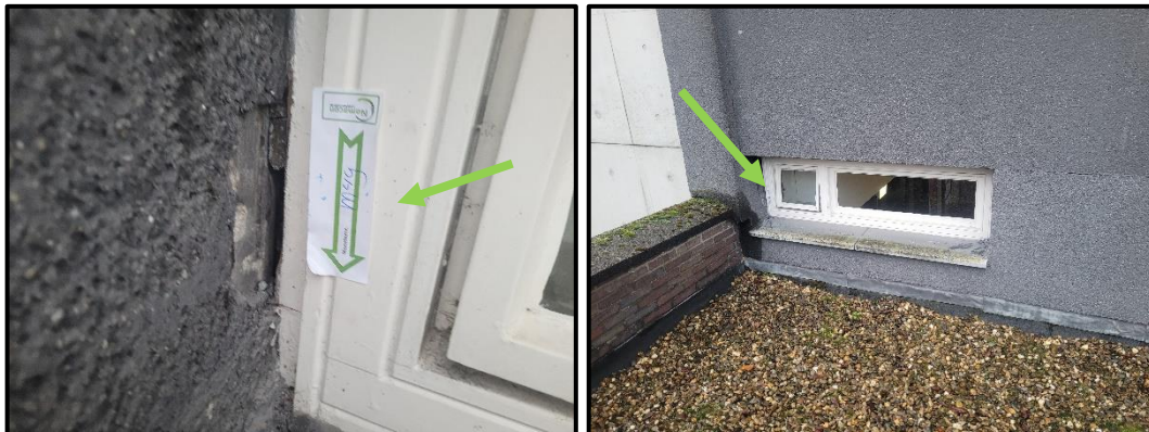
M49 – dit monster bleek na analyse niet asbesthoudend
