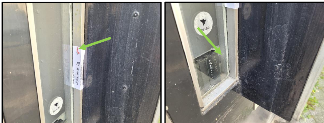
M19 – dit monster bleek na analyse niet asbesthoudend
