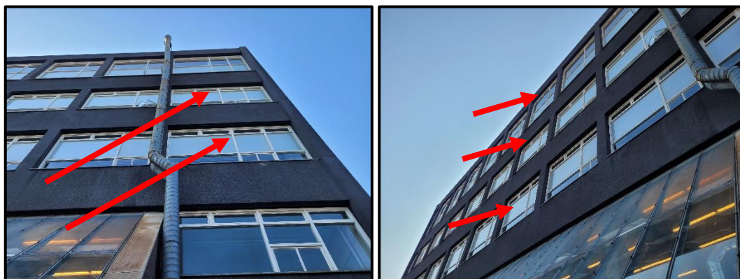
Bron 4: asbesthoudende beglazingskit in gevelkozijnen bouwdeel C
