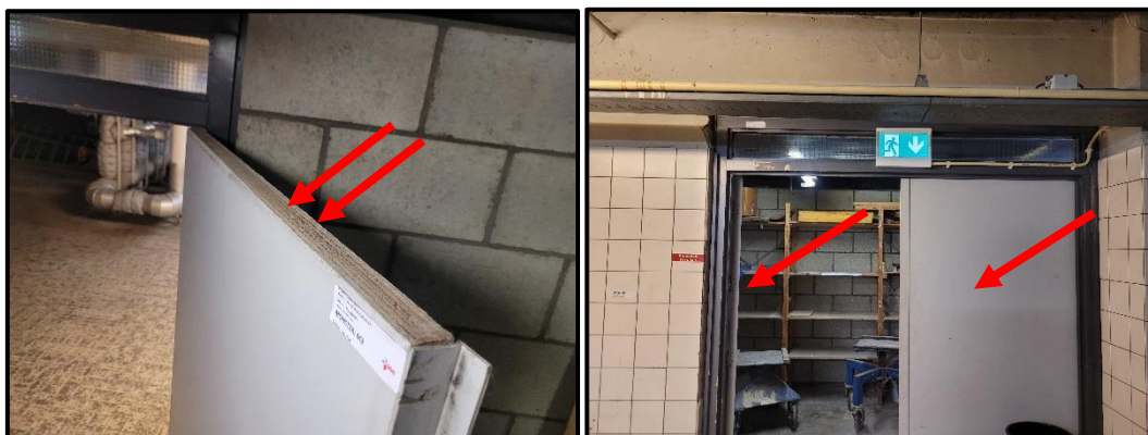
Bron 2/M3: asbesthoudende plaatmateriaal verwerkt in deuren
