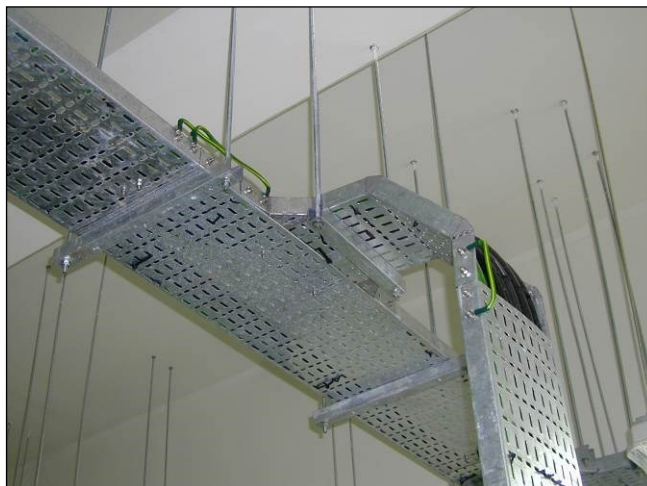
B Koppeling kabelgoot – apparatuurkast
