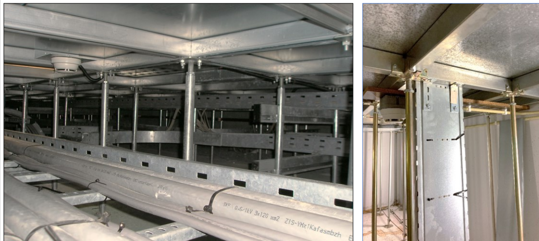
Figuur 14.3: Verhoogde vloer met onderling geleidende staalconstructie
