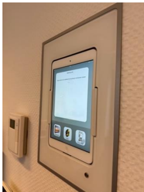
Huidige (secundaire) bedieningspositie bestaande situatie via tablet met wandhouder.
