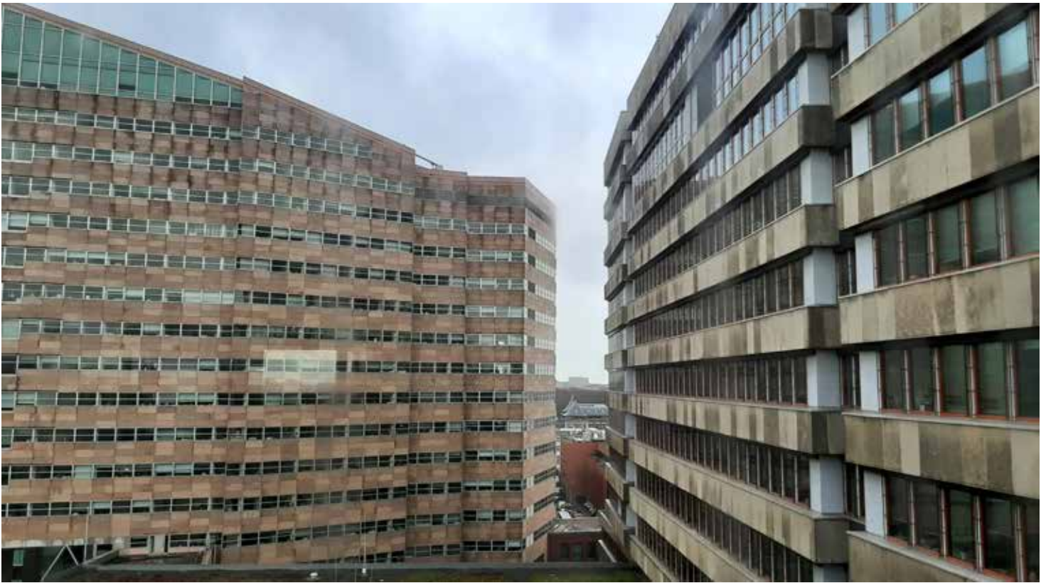
Het gevelmateriaal is verveerd en heeft veel van zijn representatieve waarde verloren. De gekozen materialen voor P2 hebben te beperkt relatie met P1 waarmee het complex niet als eenheid wordt herkend
