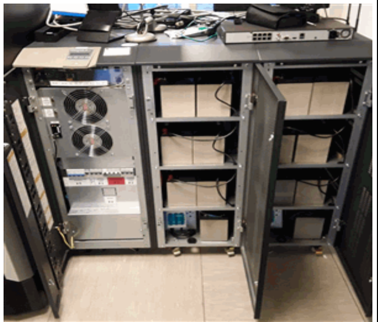
Externe batterijen de UPS
