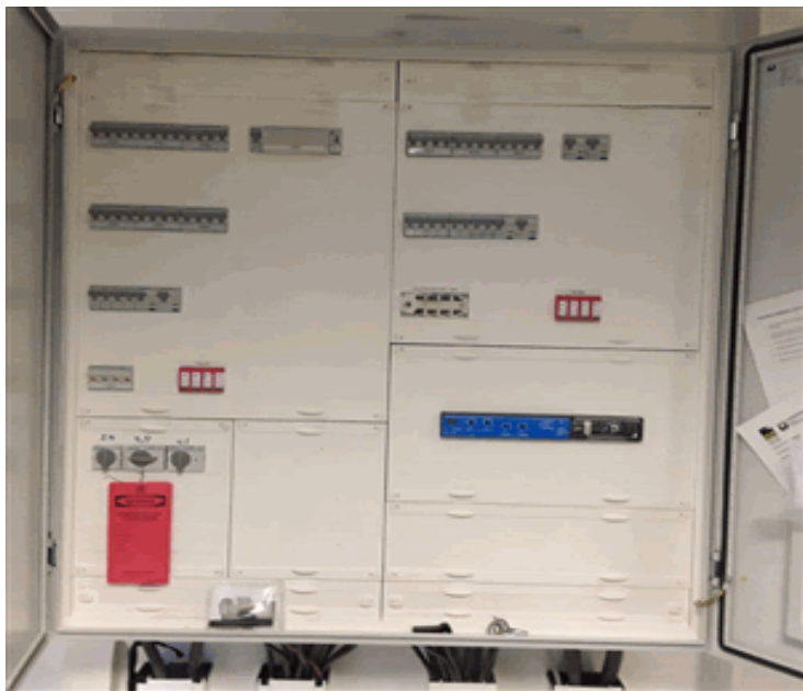
Externe bypass in verdeelkast geplaatst
