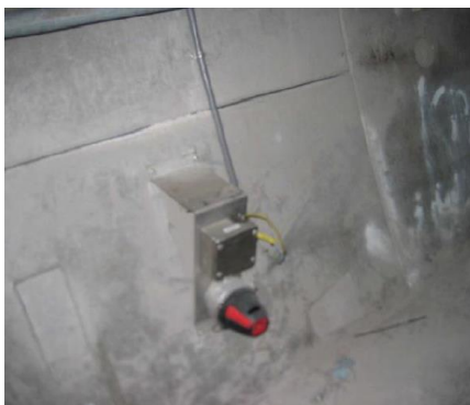
Figuur 5: Gasdetectie tunnelbuis
