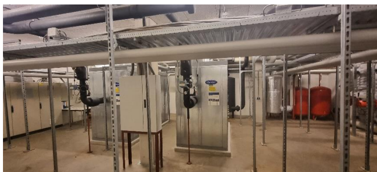
Luchtbehandeling (warmtepompen) in de kelder
