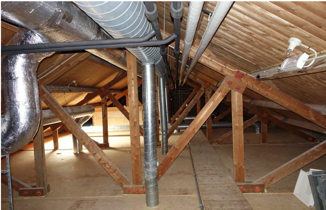
De afgeplate balklaag van de zolder van bouwdeel 1963 gezien naar de rechterzijde.
