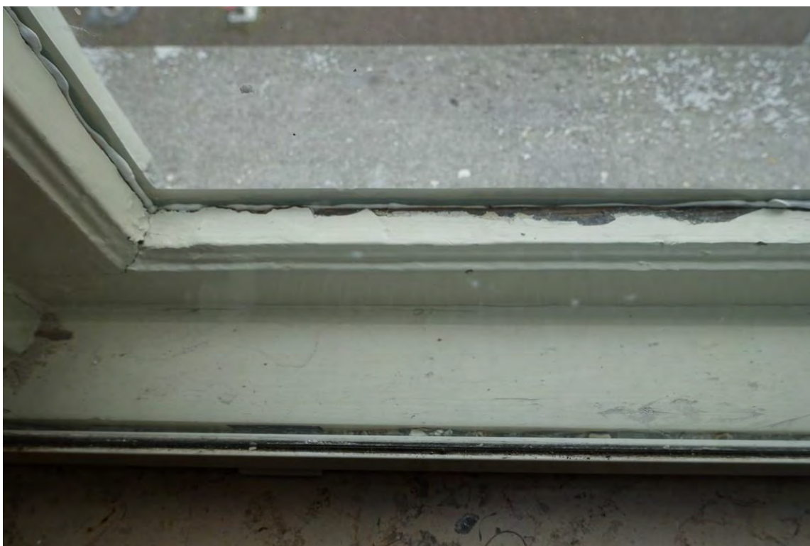
De binnenzijde van de een van de ramen. Een aantal ruitjes is recent vervangen, waarbij de afgebladderde verf zicht geeft op het eiken raamhout. Het fijne profiel past goed in de 19 de eeuw. Een aantal ruiten is nog oorspronkelijk.
