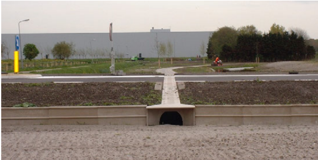
Figuur IV- 13 Halfopen amfibieëntunnel.
