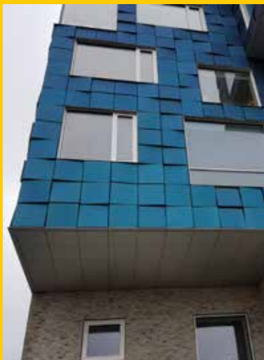
zonnepanelen op een aantrekkelijke wijze verwerkt in gevel
