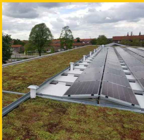
voorbeeld van sedum dak op supermarkt gecombineerd met PV
