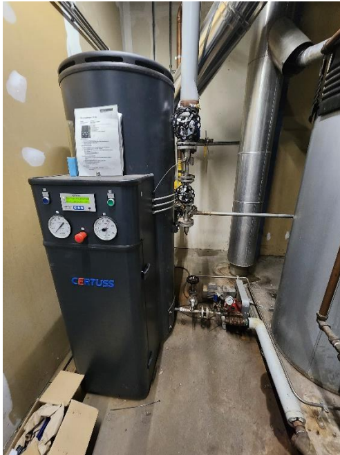
Figuur 2 Bestaand Ketel
