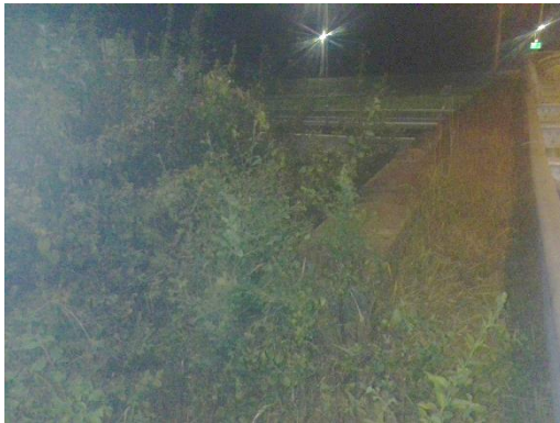
Foto 3. Te zware begroeiing en diepgelegen talud voor boorpunt 1.3-001.
