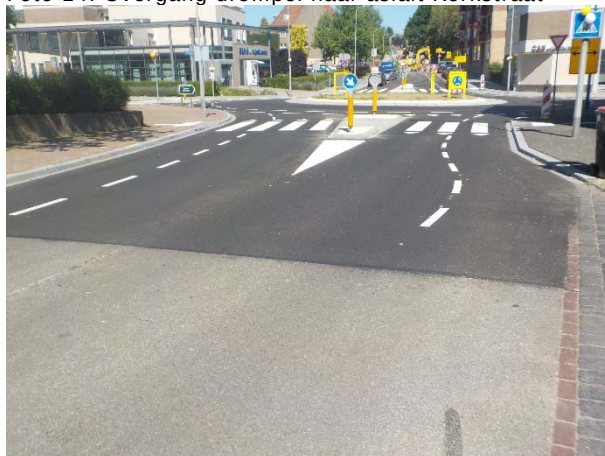
Foto 16. Overgang ander asfalt Kerkstraat
