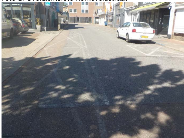
Foto 3. Overgang ander asfalt op de Kerkeveldstraat
