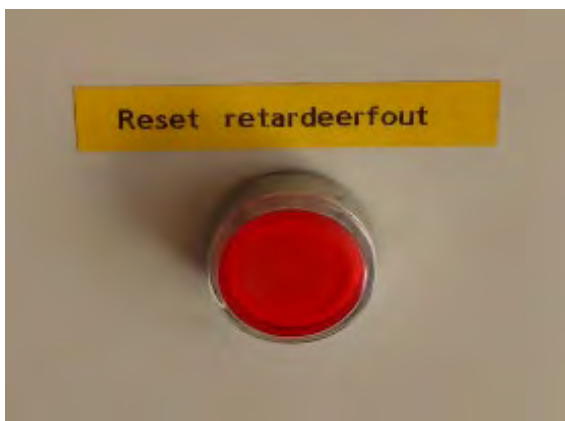
Foto 12.1: Drukknop “reset retardeerfout” op schakelkast schakelruimte
