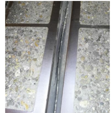
Figuur 3-80: Voegovergang HRL-STP 03, scheur in rubber afdichtingsprofiel
