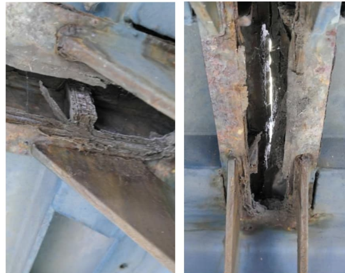
Figuur 3: Corrosie aan schotten en verstijvers nabij voegen deksecties
