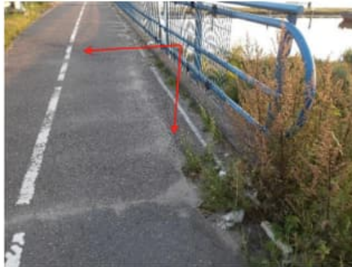
Figuur 2: verzakking/schade asfalt fietspad PRL-Noord
