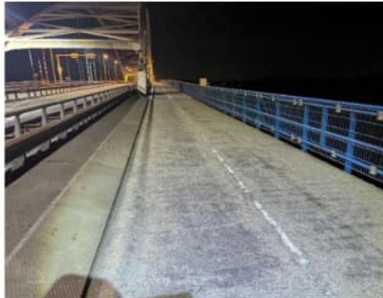
Figuur 3-45: conditie slijtlaag tijdens inspectie
