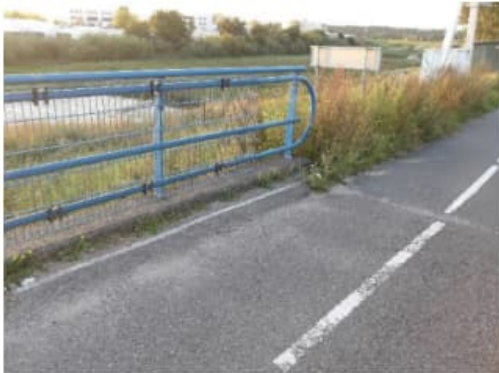
Figuur 1: verzakking/schade asfalt fietspad PRL-Noord
