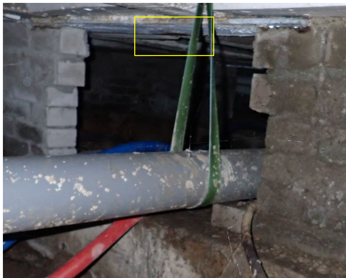
Figuur 4.10: Stalen profiel gecorrodeerd / vervuild
