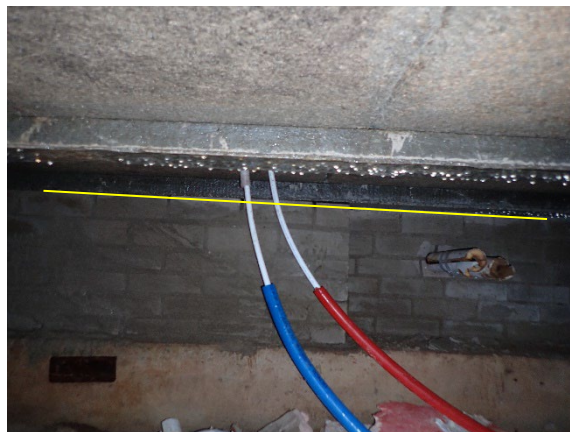
Figuur 4.2: Druppels aan balken, leidingen ongeïsoleerd
