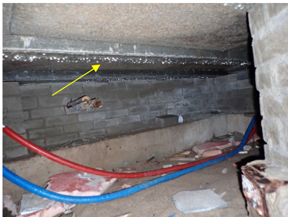
Figuur 4.1: Bouwafval en vocht in de kruipruimte
