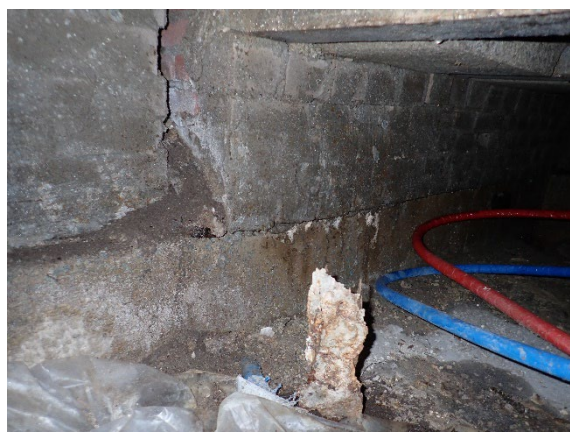
Figuur 4.6: Scheur of dilatatie in fundering waardoor grond in spoelt. De scheur / dilatatie loopt door metselwerk, niet in beton
