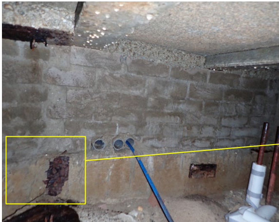
Figuur 4.7: Mogelijke scheur in betonnen funderingsbalk?
