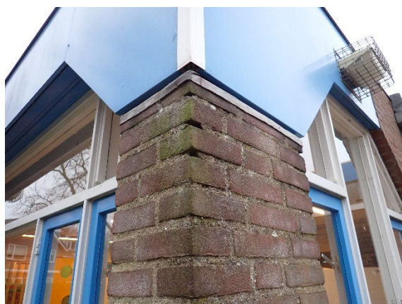
Figuur 4.4: Voegwerk verzand en uitgewassen
