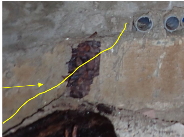
Figuur 4.8: Mogelijke scheur in betonnen funderingsbalk?
