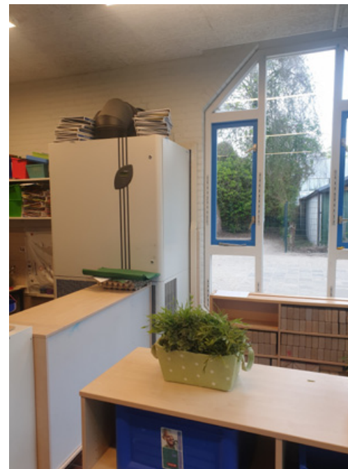
Ventilatiekast in een groepsruimte
