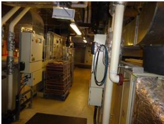
Foto 1 Opslag in technische ruimte
