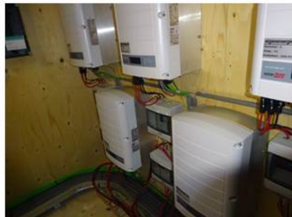
Foto 6 Omvormers PV installatie
