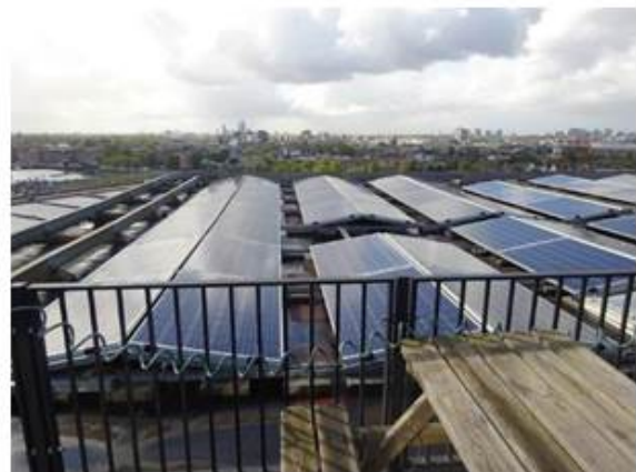
Foto 4 Zonnepanelen op dak bij dakterras
