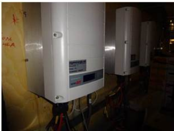
Foto 3 Omvormers PV installatie
