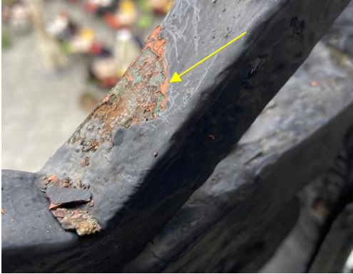
Sondering op balustrade van balkon: dik verflagenpakket
