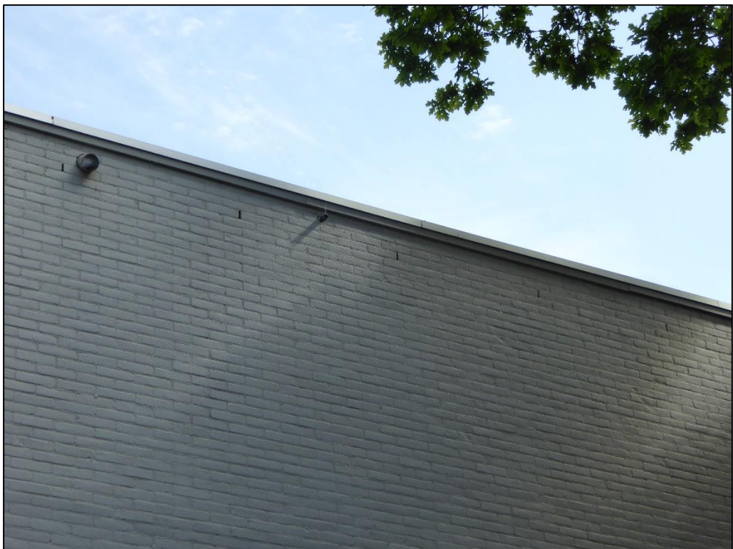
Open stootvoegen bij schoolgebouw in deelgebied 2.
