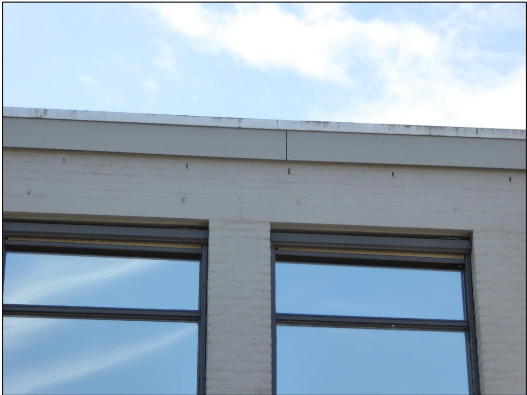
Open stootvoegen bij schoolgebouw in deelgebied 1.
