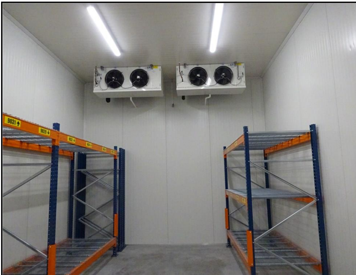
koelcel 1e verdieping
