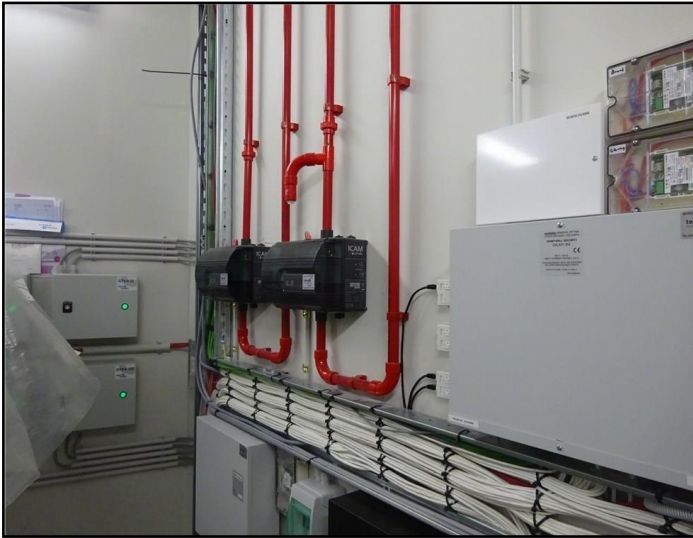
aspiratiedetectie voor traforuimte
