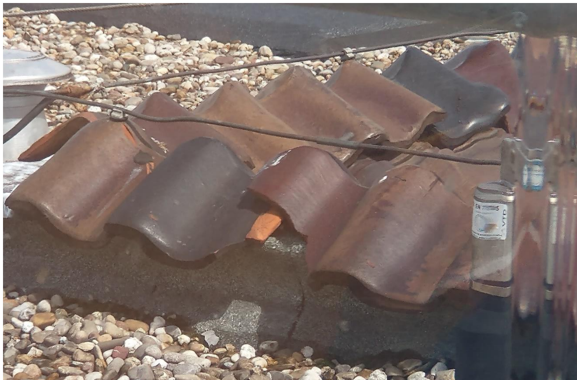
Afbeelding 4.11 waargenomen kapotte dakpan op het dak
