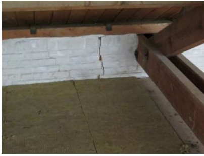
Scheur in metselwerk binnenblad onder muurplaat
