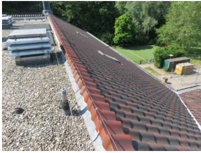
Verouderde loodaansluiting tussen bitumen en dakpan
