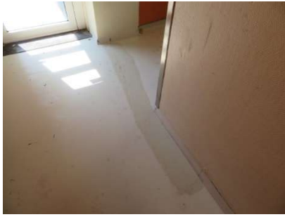
Zichtbare oneffenheden in vloerafwerking door ontbreken dilatatie
