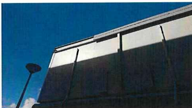
Schade aan dakrand Portakabins
