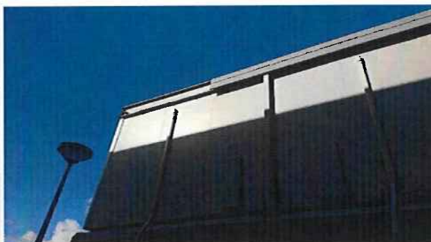
Schade aan dakrand Portakabins
