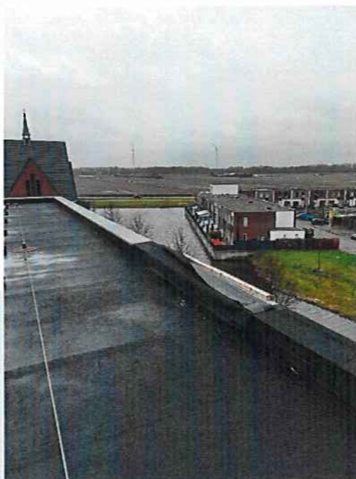
Schade aan dak hoofdgebouw
