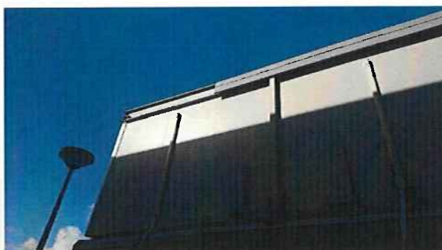
Schade aan dakrand Portakabins
