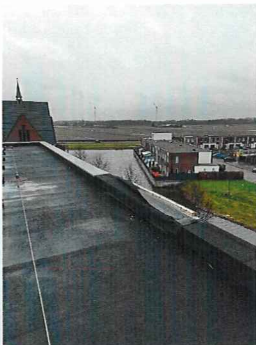
Schade aan dak hoofdgebouw
