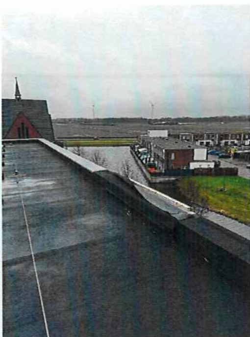
Schade aan dak hoofdgebouw
