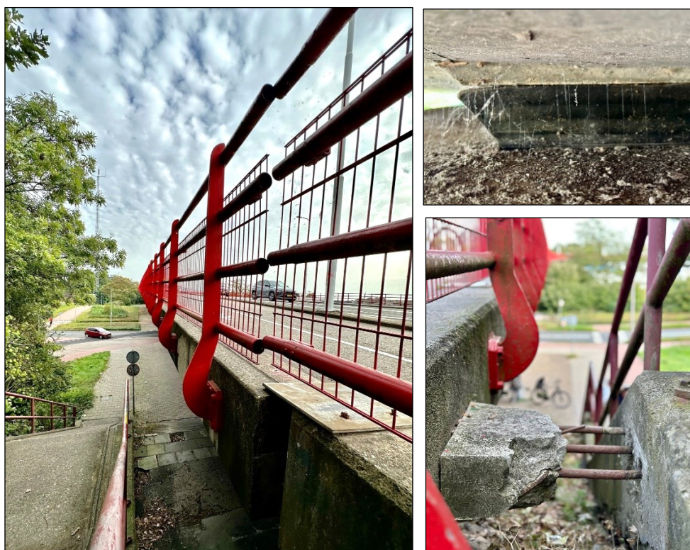
Figuur 12 - Deformatie aanbrug Zwijndrechtzijde
