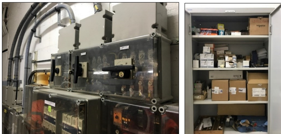
Figuur 18 - Impressie elektrische installaties
