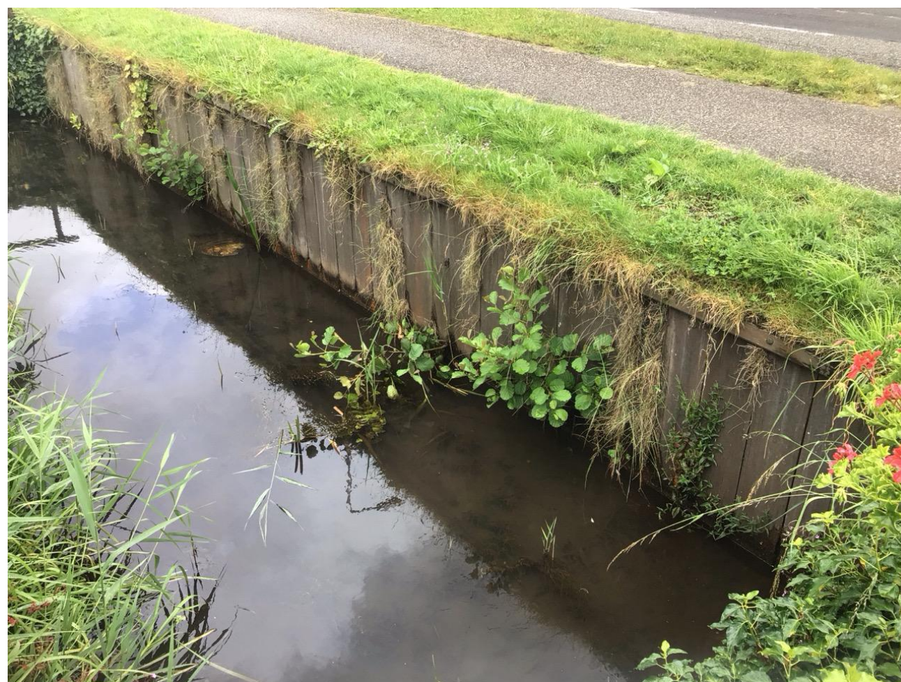
Afbeelding: onderhoudsachterstand oeverconstructies
