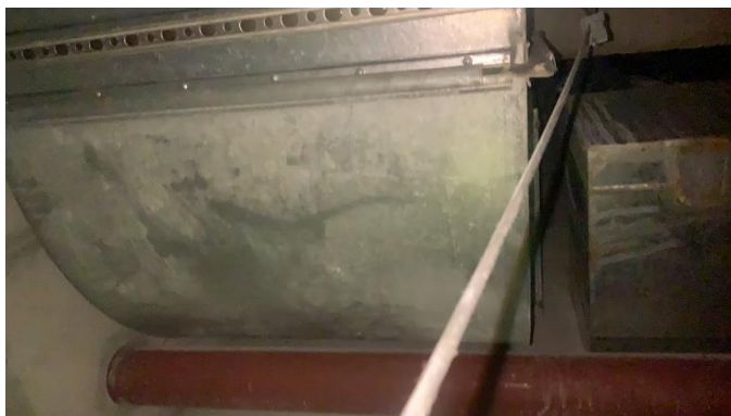
Foto 2: Plaatsen brandkleppen niet mogelijk
