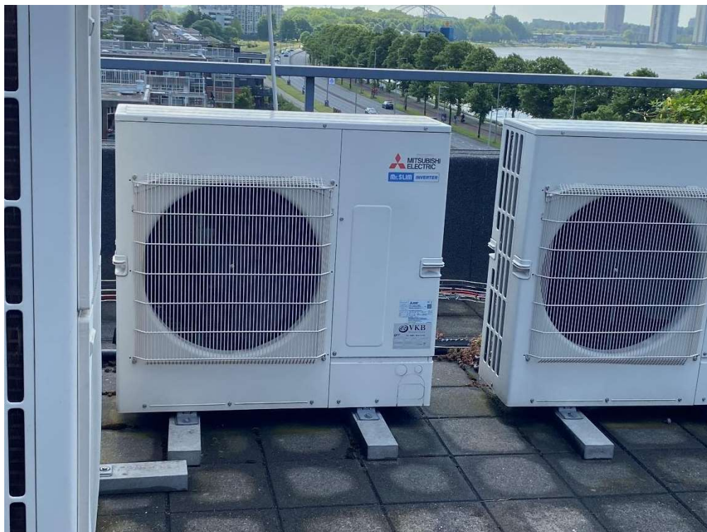
Koeling verschillende VV - zalen
