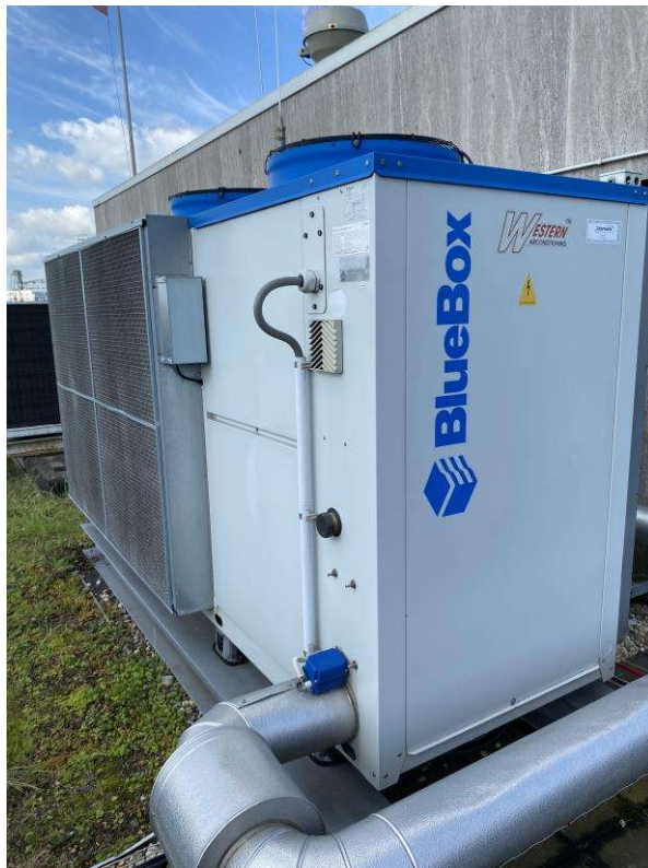
Koeling, corridor en fundament (inductie)(Western)
