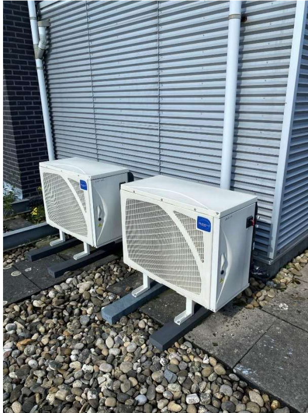
Dak Caroussel, koeling keuken (in onderhoud Hakvoort)
