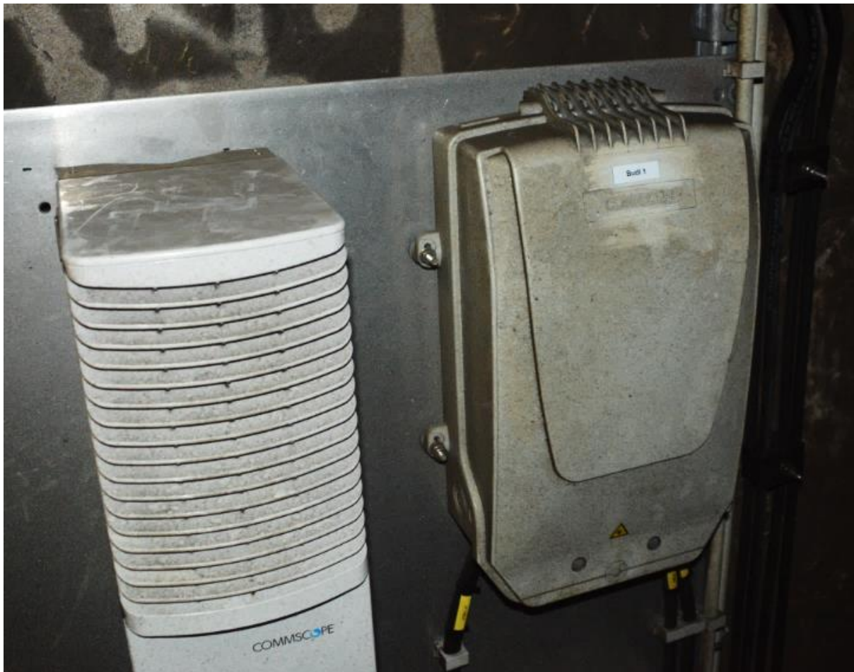
Figuur 10: Vervuiling van ION 1, noordzijde tunnel, buis H, vier maanden na plaatsing
