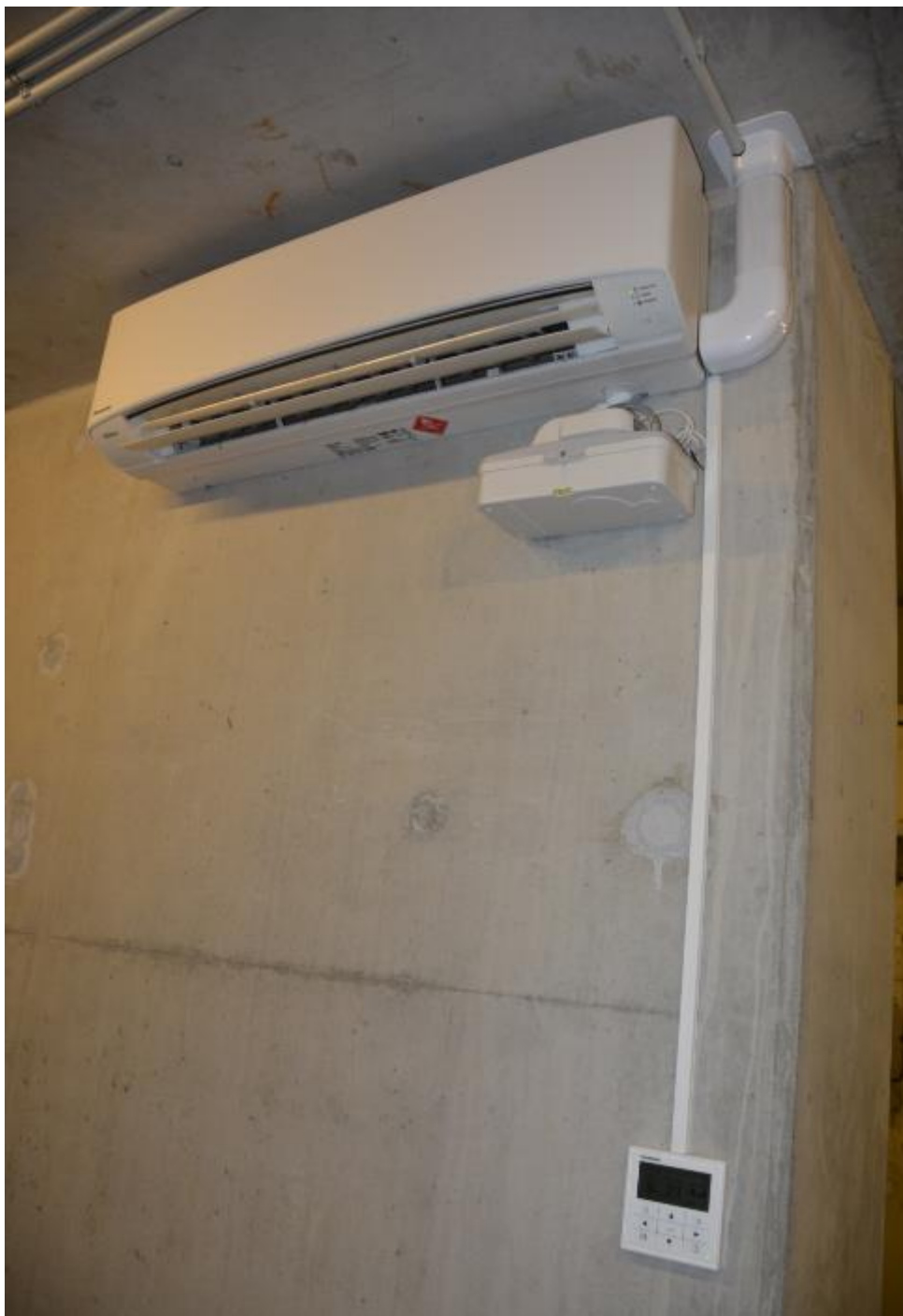
Figuur 9: De (nieuwe) airco binnenunit van Publieke Telecom is aangebracht op de pilaar midden in de ruimte
