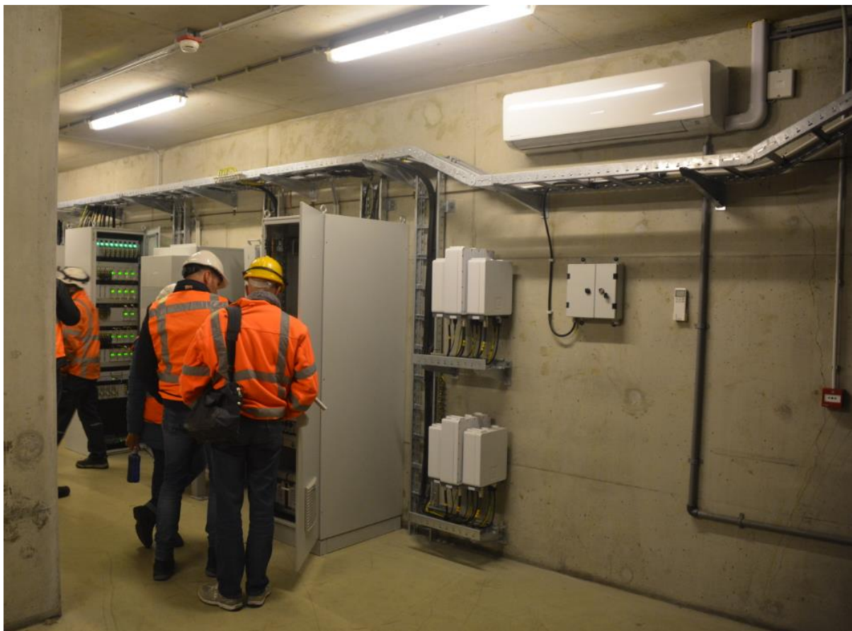
Figuur 8: Bestaande ProRail airco t.b.v. GSM-R (binnenunit)
