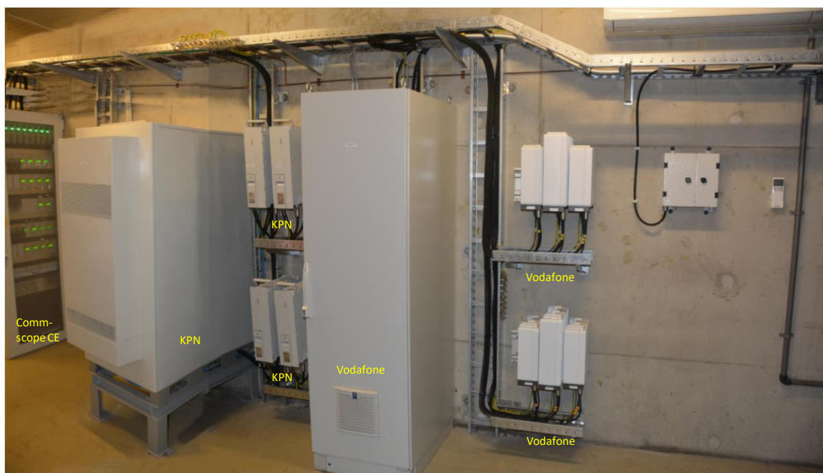
Figuur 14: Opstelling apparatuur in MER, gebouw Pompenburg. 4 november 2020
