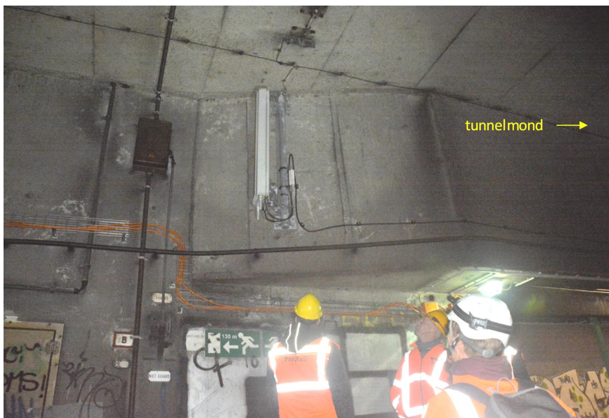
Figuur 18: Antenne van ION 1, spoor J, bij tunnelmond Pompenburg (binnenzijde)
