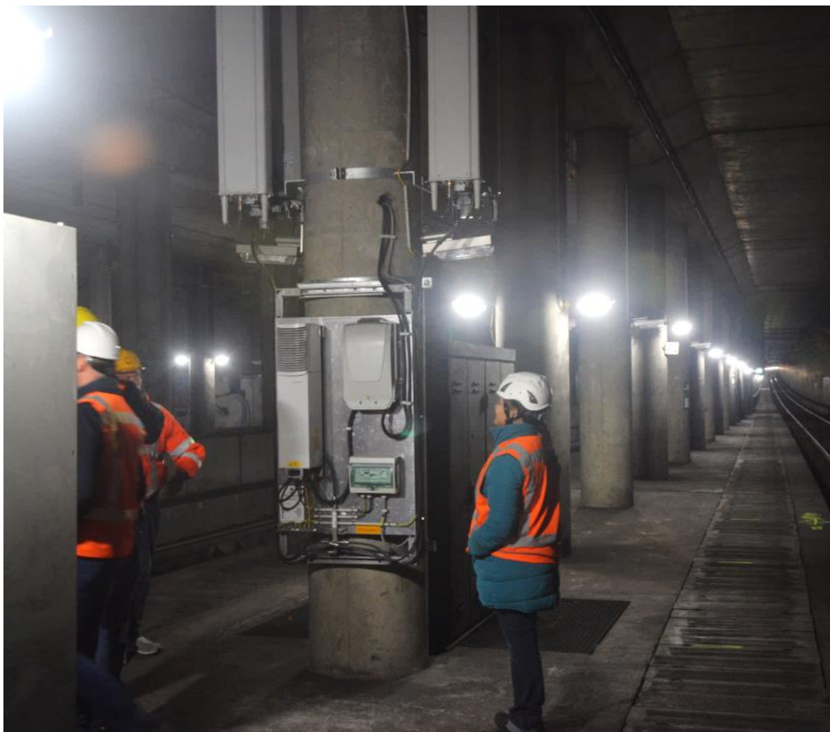
Figuur 22: ION 7 met vier antennes, aan het einde van het perron van station Blaak. Foto in noordelijke richting.
