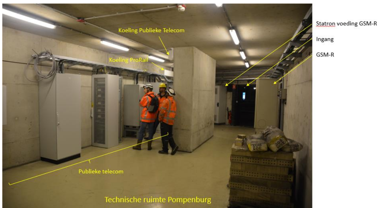
Figuur 13: Opstelling apparatuur in MER, gebouw Pompenburg. 4 november 2020
