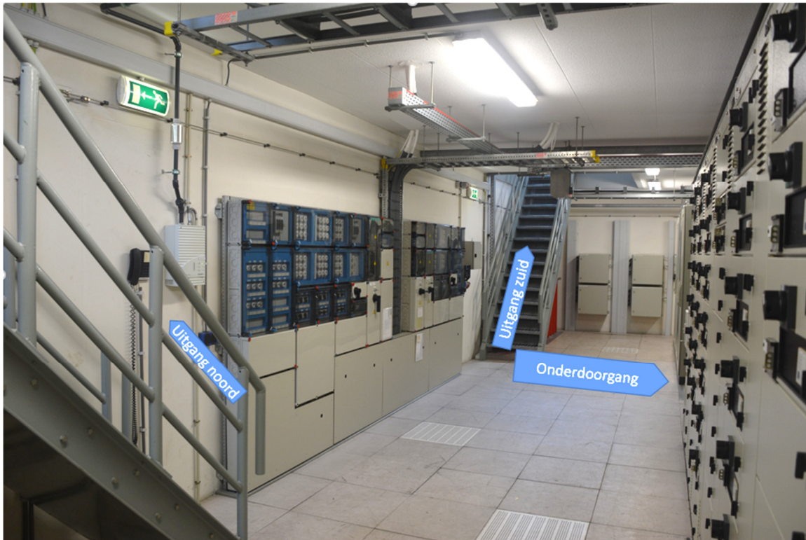
Figuur 6: Centrale ruimte in Technisch Gebouw Noord, toegang tot onderdoorgang naar ORL 2
