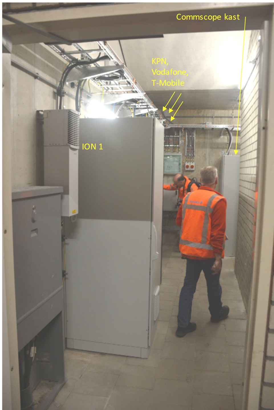
Figuur 6: Technische ruimte 7-Oost
