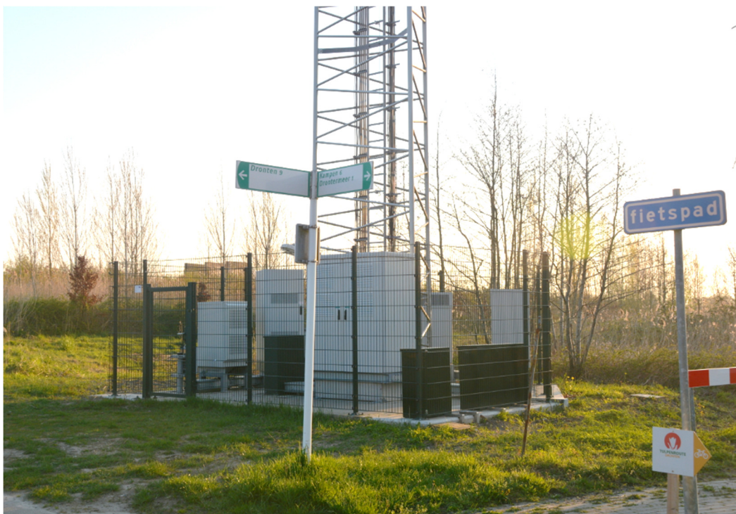
Figuur 4: CE bij vakwerkmast nabij DGB-West. Op de achtergrond DGB-West.
