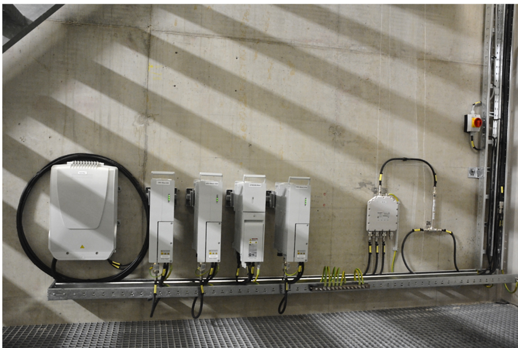
Figuur 5: AS1. DRH onder in trappenhuis van dienstgebouw West
