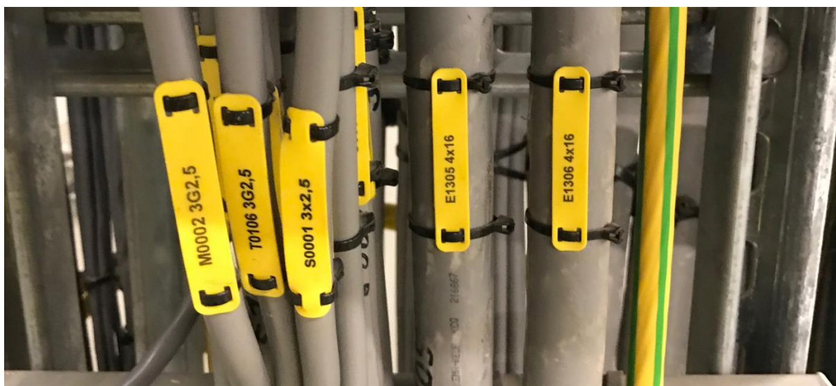
Figuur: labels kabels dienstgebouw west Sophiaspoortunnel
