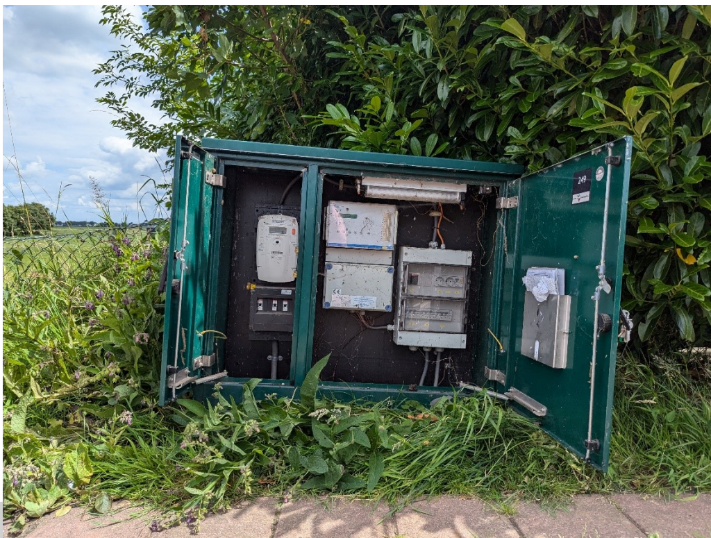
Beeld van de installaties NEN3140 Inspecties volgens SCIOS Scope 8, riool gemalen in de gemeente Lansingerland.
