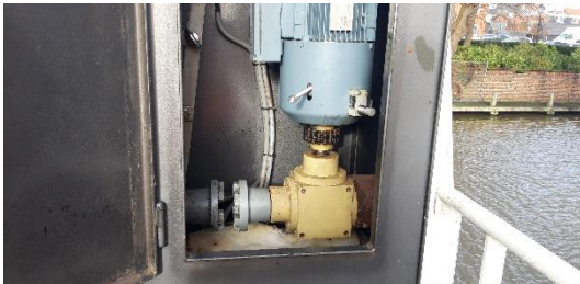
Geen verdachte elementen in de bedieningskast
