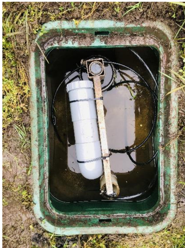
Figuur 1: bovenaanzicht straatpot; met links het luchtslot; in het midden en boven het anker en onderaan (onder het anker) de peilbuis. Op de foto ontbreekt de kabelgeleider en de druksensor die van het anker af in de peilbuis hangt.
