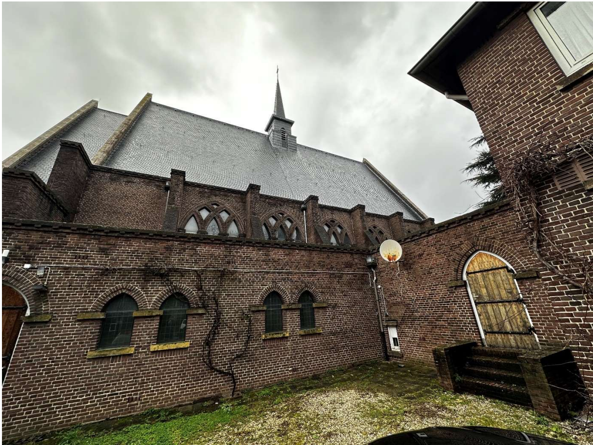
Foto 5: Vele vochtplekken, mosgroei en vereringen in het buitenmetselwerk
