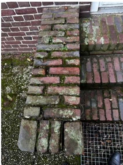
Foto 6: Slecht voegwerk en mosgroei
