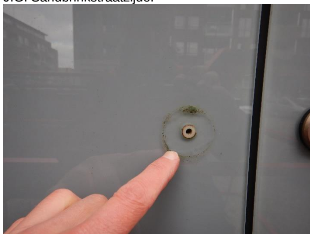
Foto 3 In de glasgaten zijn bij de schroefdoorvoeringen nylon ringen aanwezig.
