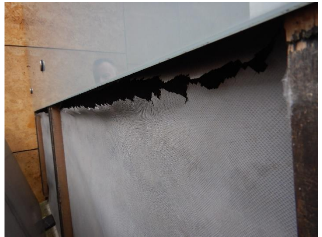
Foto 8 Het regendichte membraan achter de houten stijlen is gescheurd en algemeen niet functioneel.
