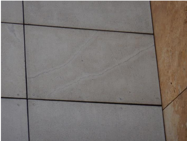
Foto 13 Plaatselijk zijn polymeerbetonnen gevelplaten gescheurd.
