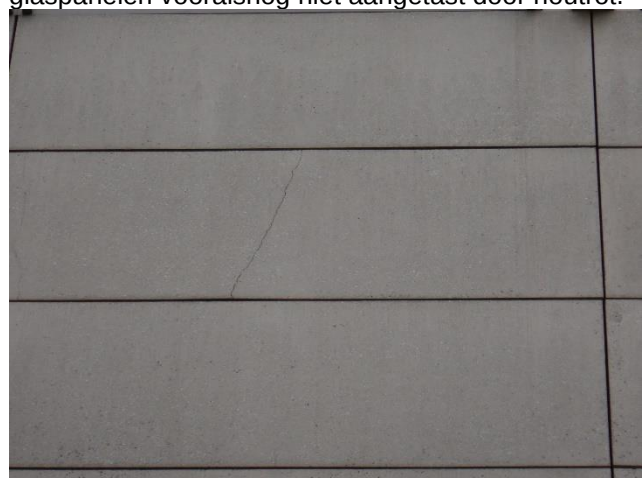
Foto 12 Plaatselijk zijn polymeerbetonnen gevelplaten gescheurd.
