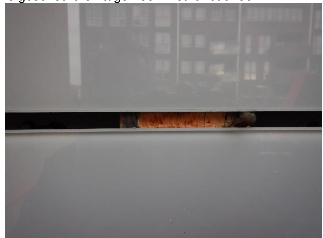
Foto 10 De houten stijlen zijn bij de voegen tussen de glaspanelen vooralsnog niet aangetast door houtrot.
