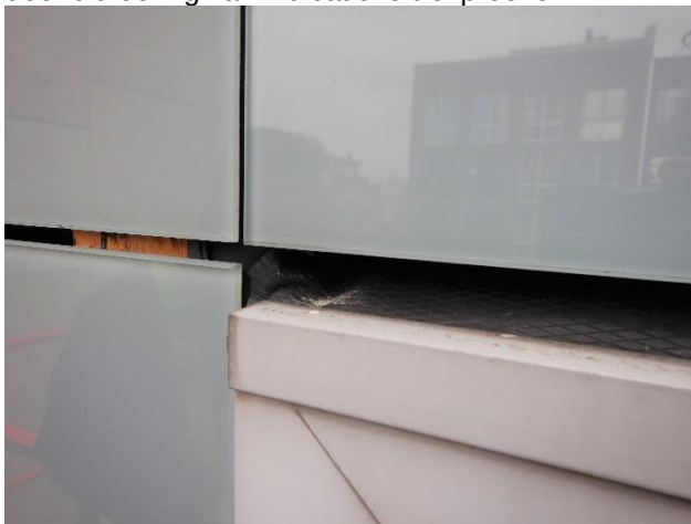
Foto 9 Op een enkele plaats is een DPC slabbe bij de bovenaansluiting van het kozijn aanwezig.
