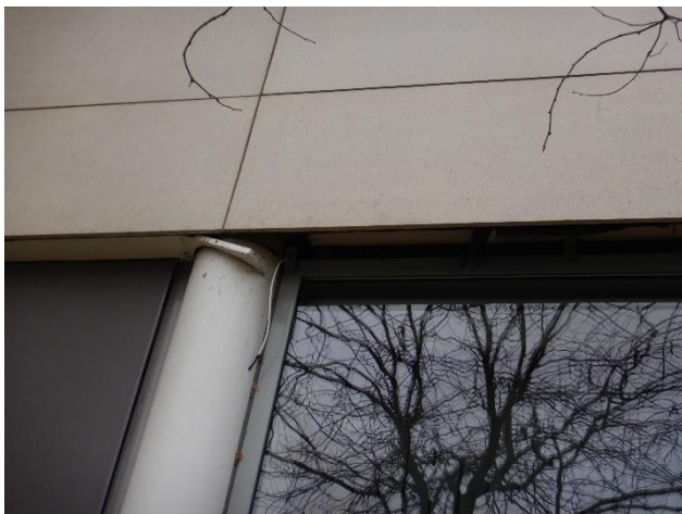
Foto 19 Incidenteel is een gevelplaatje (neggeplaatje) onder de polymeerbetonnen gevel losgekomen.
