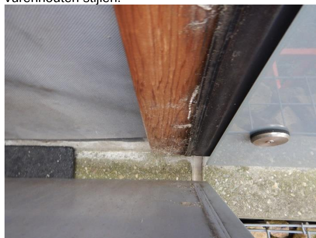
Foto 6 De houten stijlen zijn aan de onderzijde van de gevels plaatselijk aangetast door schimmels.
