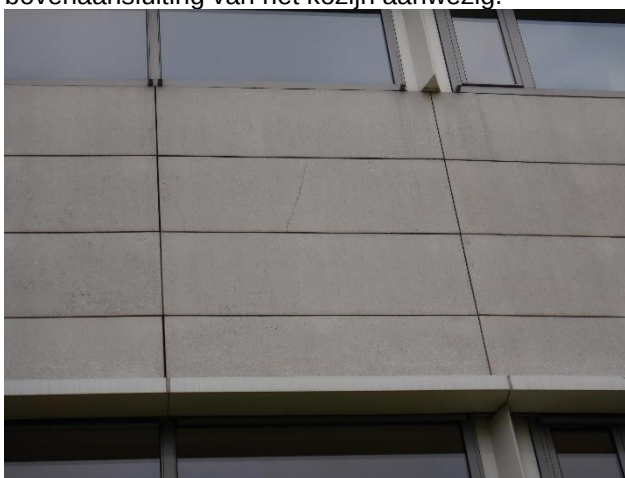
Foto 11 Plaatselijk zijn polymeerbetonnen gevelplaten gescheurd.
