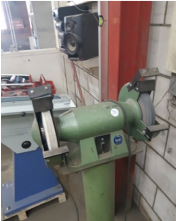
FOTO 2-9 SLIJMACHINE: HET KAN VOORKOMEN DAT DE KEURINGSTICKER AANWEZIG IS OP HET ARBEIDSMIDDEL MAAR DAT DE AFSCHERMINGEN ONTBREKEN. DIT IS EEN ONVEILIGE SITUATIE EN DIENT TE WORDEN HERSTELD.
