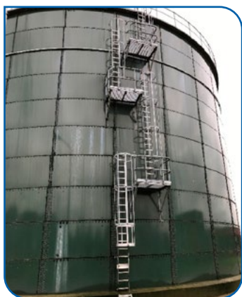
FIGUUR 2-37 TWEEDE VLUCHTWEG, GESEGMENTEERDE KOOILADDER OP TANK
