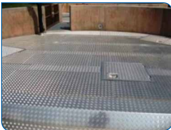
VLAKKE VLOER OM LUIK BESLOTEN RUIMTE EN LOOPPAD (VOORKOMEN VAN STRUIKEL- EN VALGEVAAR)
