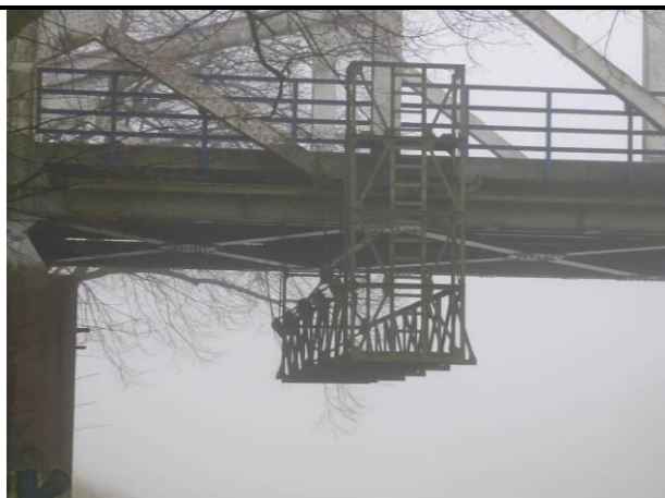
Schade (106): Inspectiewagen, Algemeen - - -
