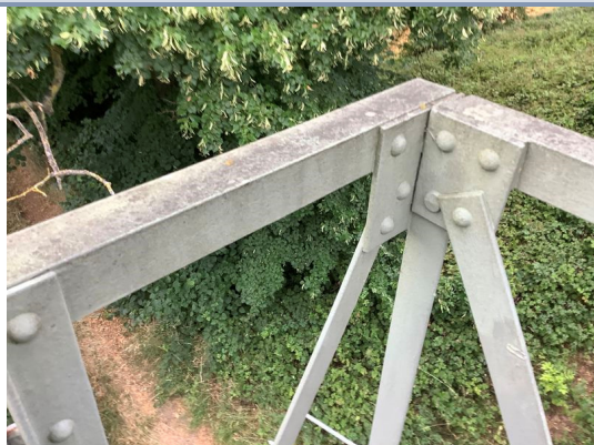
Bouwdeel: Inspectiewagen, Algemeen Nadere specificatie: Leuning inspectie wagen
