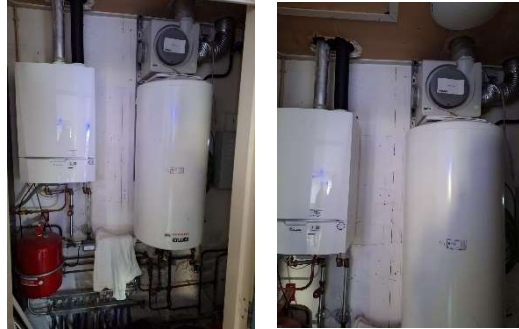
Aanzicht cv-installatie en ventilatibox wooneenheden laagbouw
