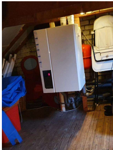
Aanzicht CV-installatie zolder
