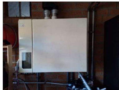
Aanzicht cv-ketel activiteiten ruimten (vrijwilligers) deze wordt vervangen
