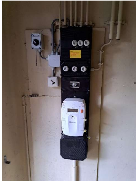
Meterkast begane grond
