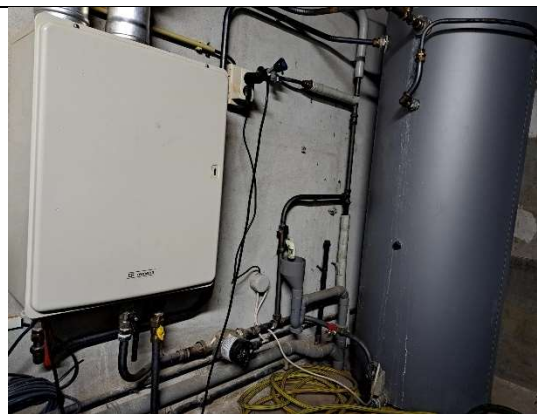
Aanzicht doorstroomtoestel en boiler
