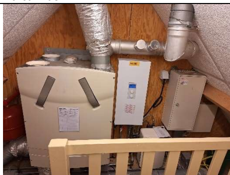
Aanzicht installaties koeshuis
