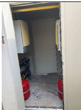
CV installatie ruimte (linker cv is afgesloten)
