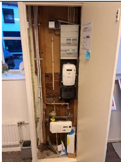
Meterkast begane grond
