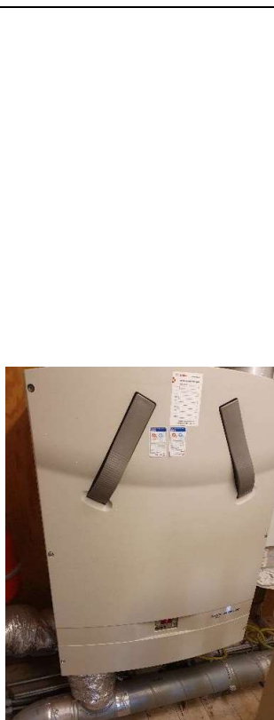
Aanzicht ventilatie box + onderhoud
