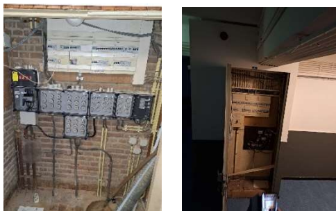
Aanzicht meterkast begane grond en 1 e verdieping
