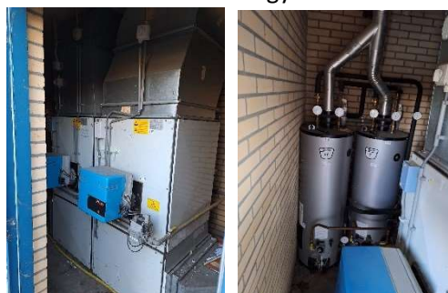
Aanzicht LBK en Boilers gymzaal
