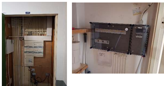
Aanzicht meterkast 2 e verdieping
