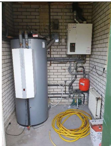
Aanzicht technische ruimte, alles buitengebruik, Nu alleen elektrische verwarming en close-in boiler
