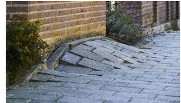
Verzakkingen: een belemmering voor personen met een beperking
