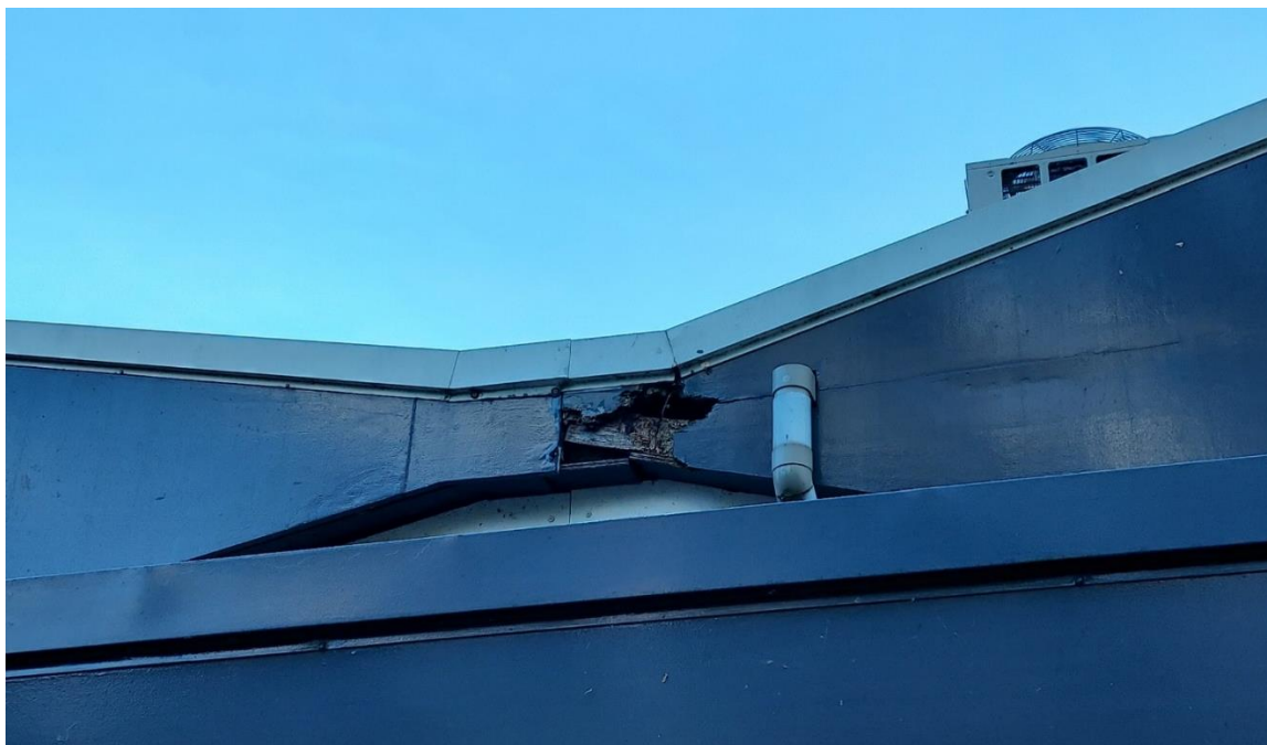
Figuur 23: Gat in het dak van de Lidl (stationsgebouw).
